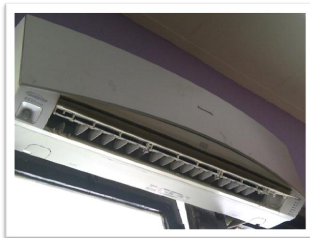
Gambar 2. kondisi AC di salah satu ruangan di ruang Angrek
