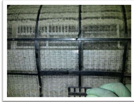
Gambar 3. Kondisi filter AC dengan ketebalan debu ringan
